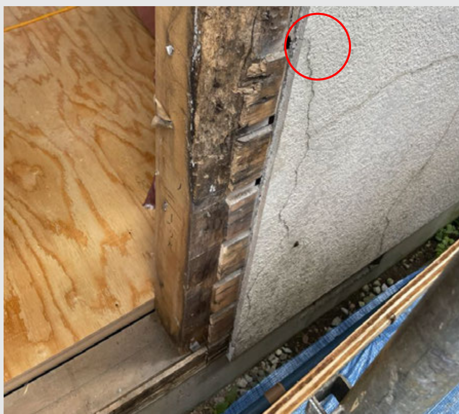
解体時…出窓横の柱に雨水が染み込み、木材腐朽菌の働きでボロボロに
