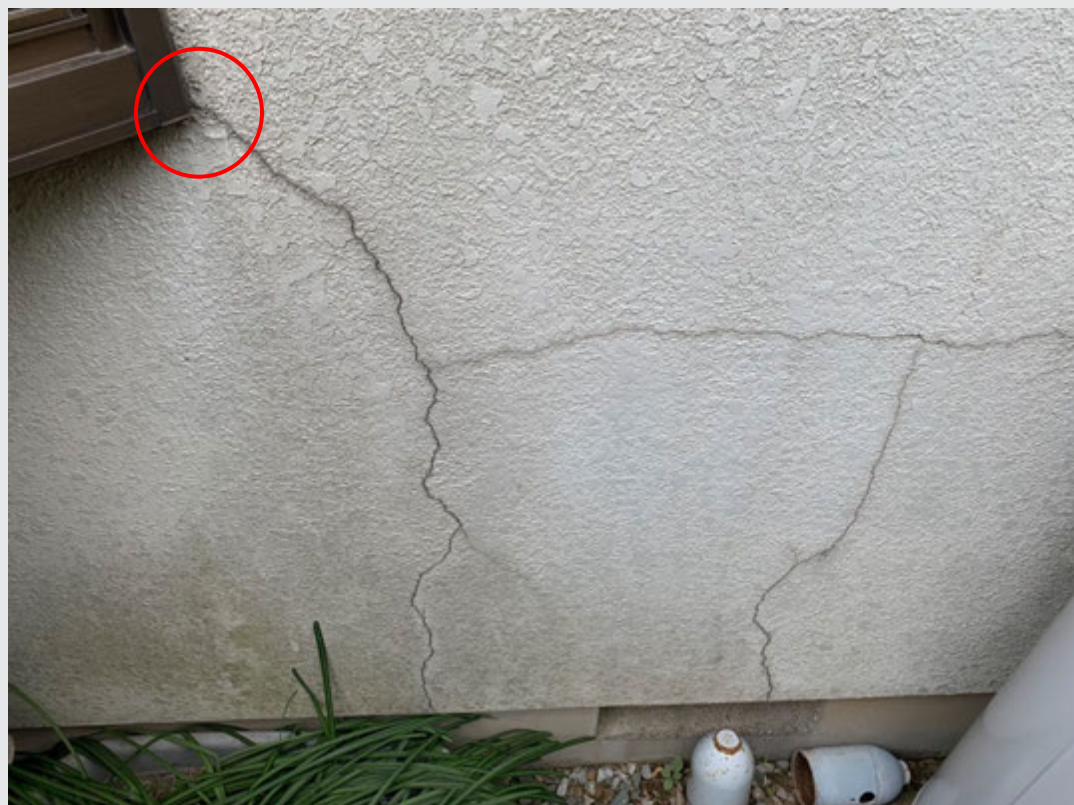
調査時…出窓横の外壁のひび割れ幅が大きく、雨水の侵入による木部の腐朽を予測
